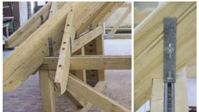
Dachkonstruktion aus Holz mit Halben HNA Nagelanschluss
