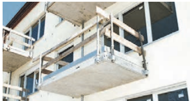
HGB schon während der Bauphase zur Absturzrisiko genutzt
