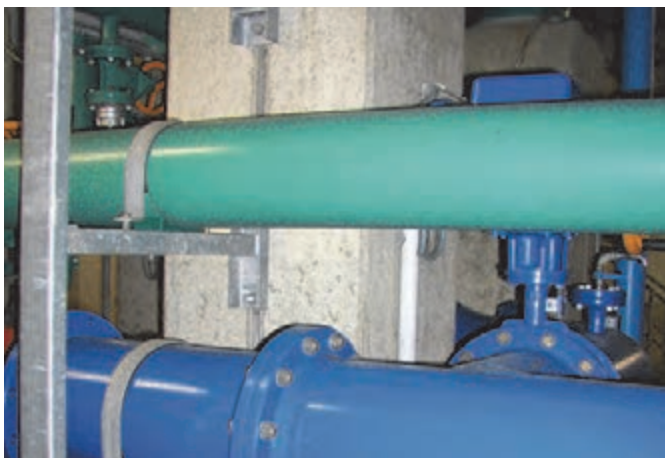
Rohrleitungsunterstützung an senkrechter HZA Schiene
